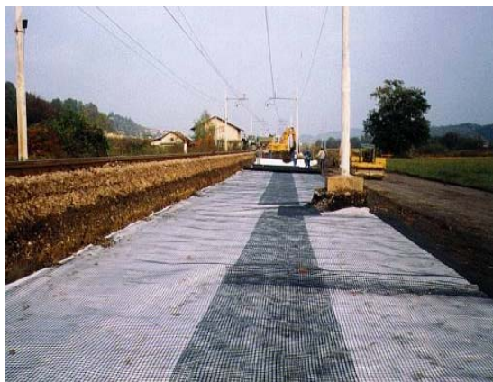
Figura 6: Fasi di sbancamento del rilevato esistente e stesa del geocomposito nella parte di massiccata ferroviaria soggetta a ripristino
